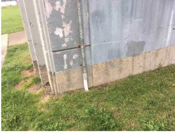
Picture #25. Electrical conduit
